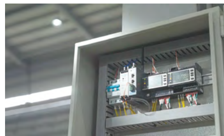
▶ 智慧電表加裝於主要製程設備
