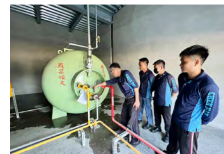
▶ 緊急應變演練 - 液化石油氣操作安全說明
